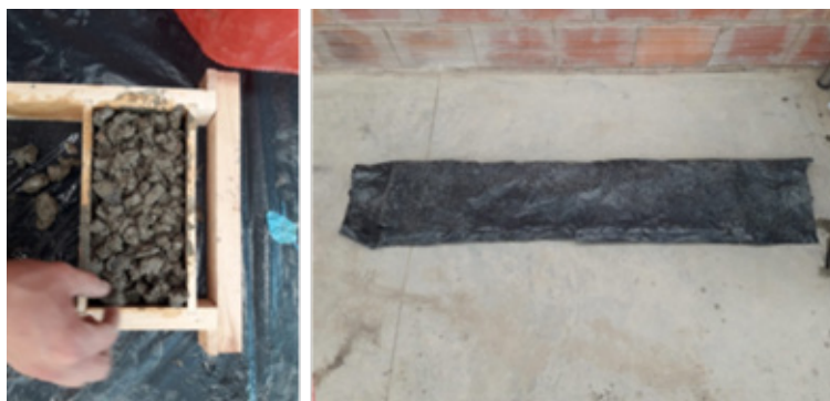
Fig 1. Fundición de adoquines permeables y protección de polietileno para la conservación de humedad.
